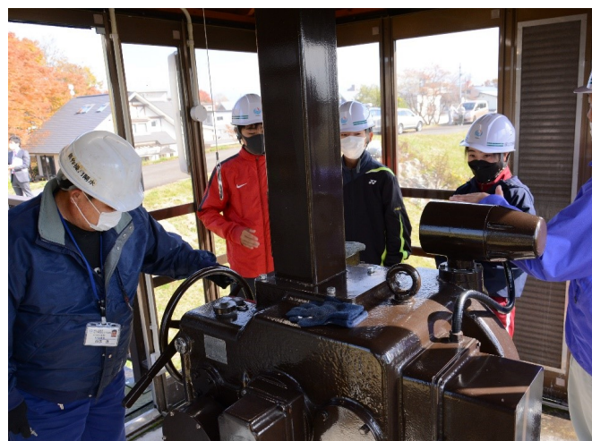
中島樋管での操作説明
