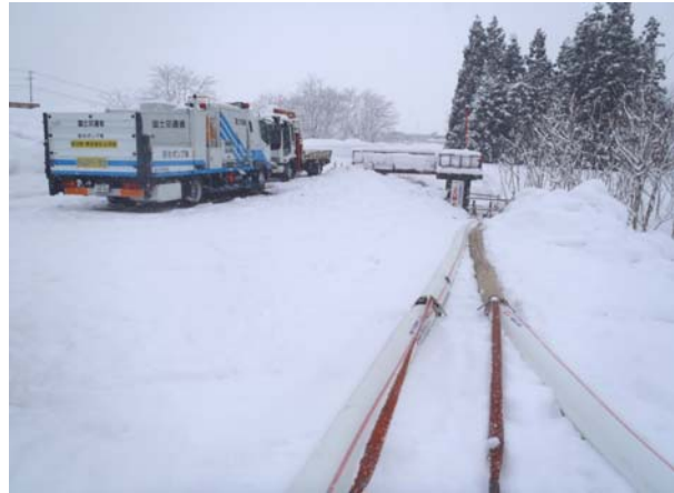
河川からの導水状況
