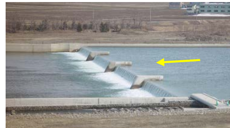
大久保堰（改築後）
