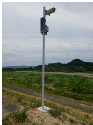
簡易型河川監視カメラ設置状況
