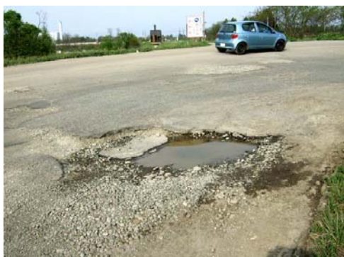
堤防の天端舗装補修前の状況
