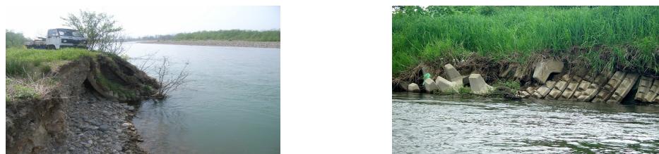
河岸崩壊の状況
