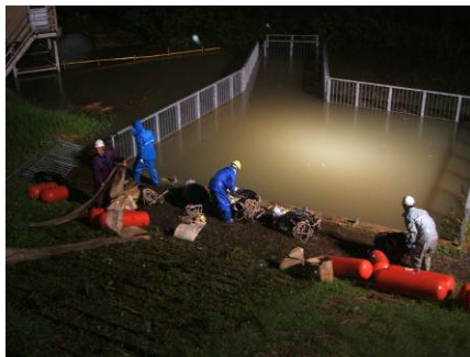
浜町排水ピット
