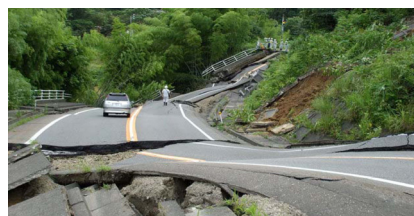
被災状況調査
