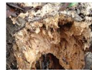
腐朽状況 (菌糸が全体に蔓延)
