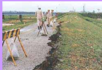
雄物川右岸 秋田市牛島地区 堤防に亀裂と沈下が発生
