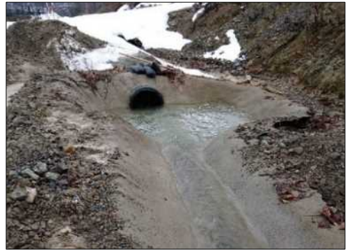
清濁分離工 (清水のまま河川へ流下させる導水路)
