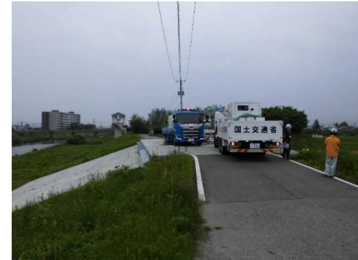
堤防乗越施設天端の排水ポンプ車配置確認状況
