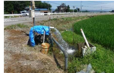
川から取水ができずに、地下水を汲み上げている状況
