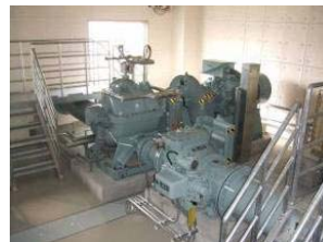
松沢川揚水機場 (機械設備)
