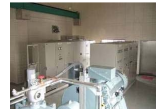
松沢川揚水機場 (電気通信設備)
