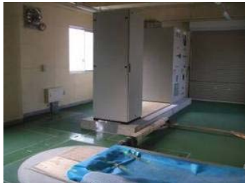
鉦打沢川揚水機場 (電気通信設備)
