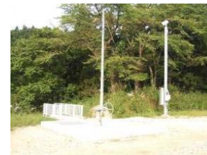
松沢川着水槽
