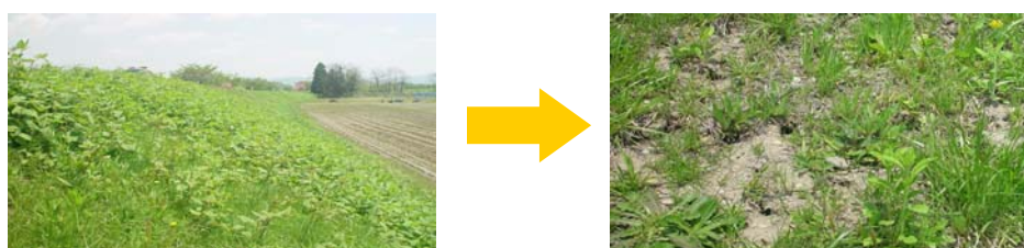
有害な植生（イタドリ等）の進入による堤防の裸地化
