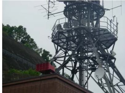
玉川ダム 放流警報施設
