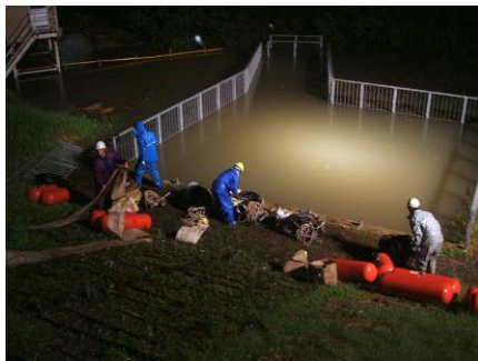
浜町排水ピット
