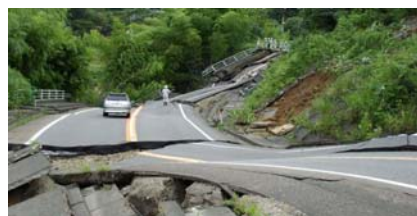
被災状況調査
