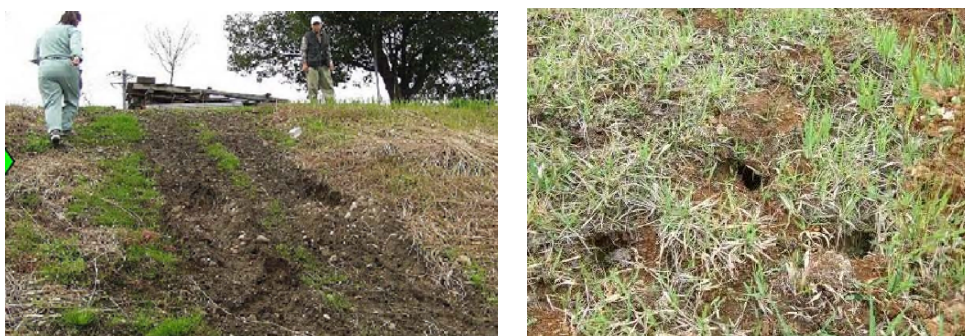
堤防変状状況（車輛による損傷、モグラ穴）
