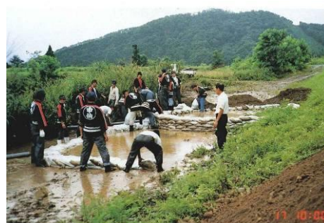
漏水被害の状況 (秋田県大仙市鑓見内地先)
