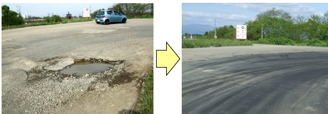
堤防の天端舗装補修前の状況
