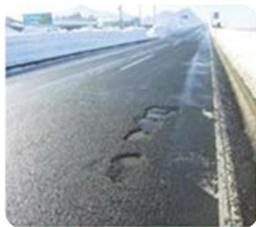
路面の穴ぼこ・ 段差
