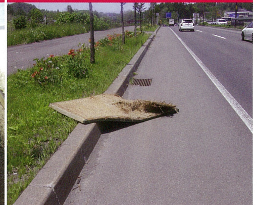
路面の落下物
