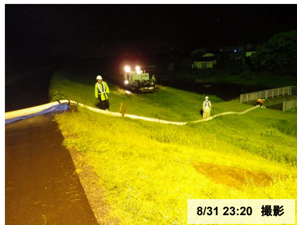
排水ポンプ・ホースの設置状況
