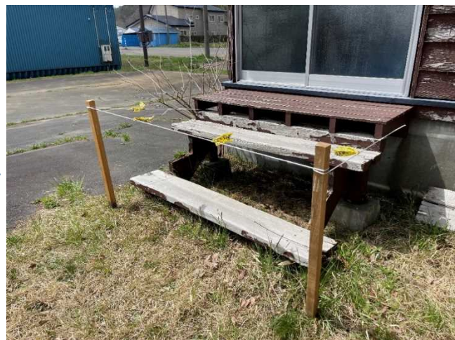
不具合箇所(木製階段の破損) 撤去、立入防止措置済み
