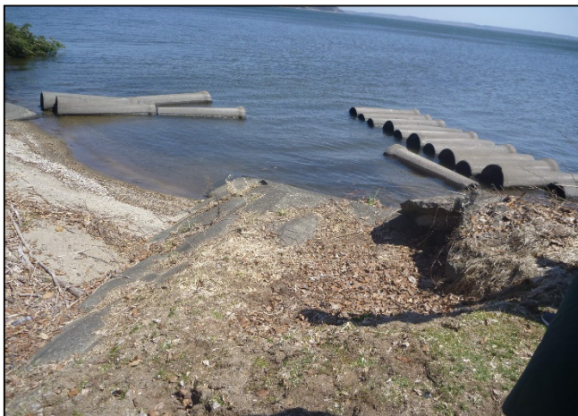
護岸が洗掘されていました。
