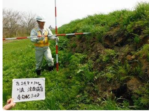
▲堤防法面の崩落
