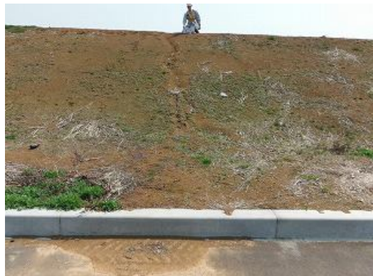
▲雨水による法面浸食
