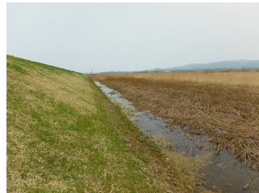
▲堤防法尻の水溜まり
