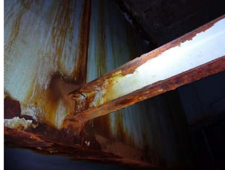
主桁の板厚減少が視認できる腐食
