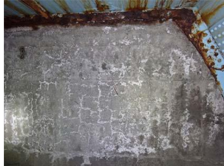
床版に遊離石灰を伴うひびわれ
