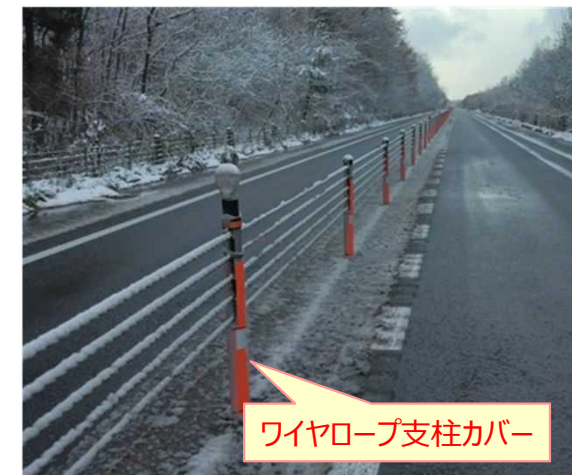
▲ワイヤロープ支柱カバー
