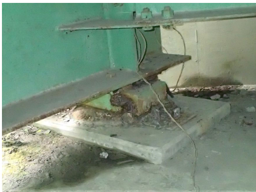
【損傷】支承の腐食
