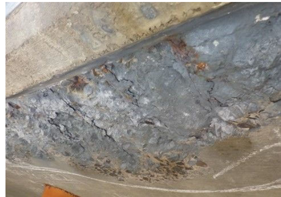
床版下面張出部劣化状況
