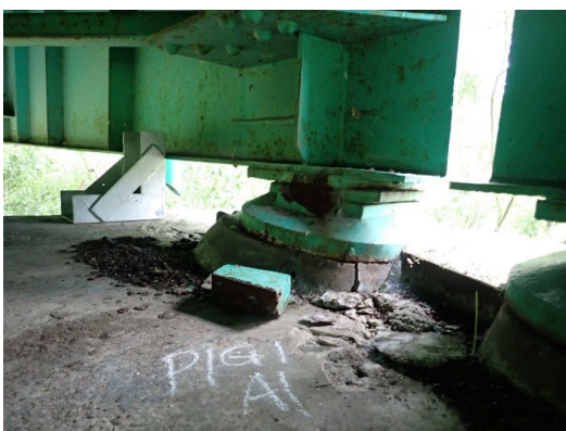
【損傷】支承の腐食・変形
