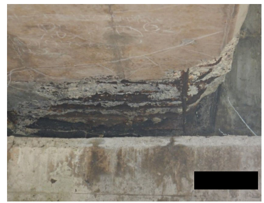
【損傷】浮き、はく落
