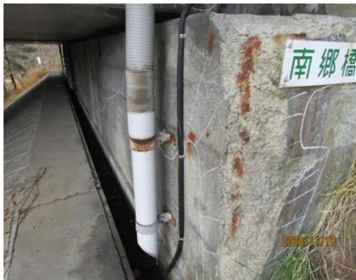
【損傷】橋台前面に浮き （剥離、剥落、鉄筋露出）
