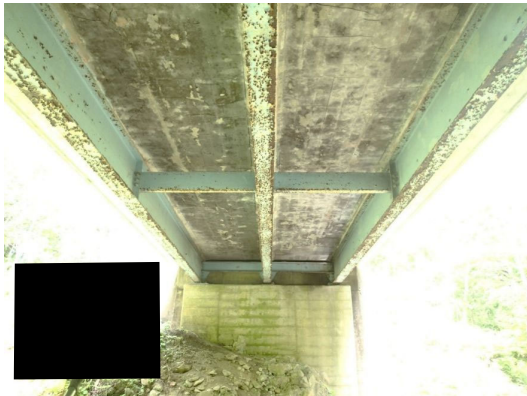
【損傷】主桁の腐食
