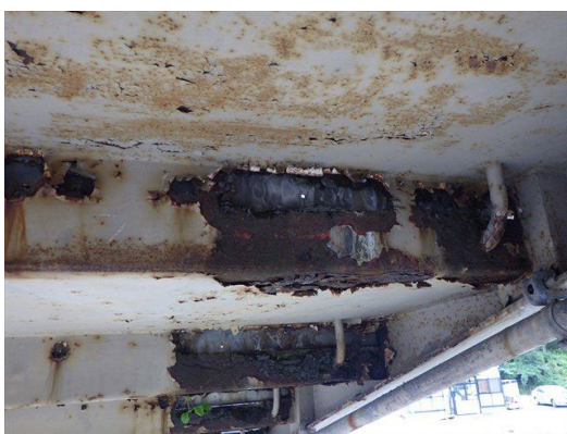
【損傷】階段蹴上げの腐食、変形・欠損
