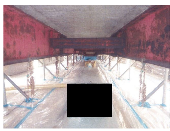
【損傷】主桁の腐食
