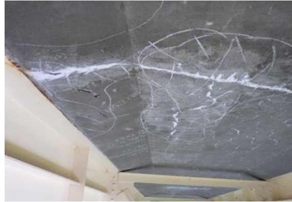
床版下面劣化状況
