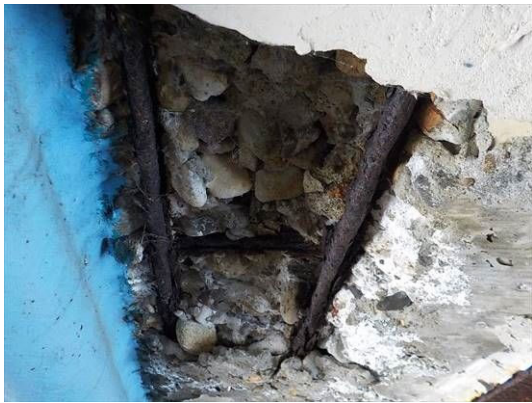
写真 4-8 【損傷】鉄筋露出
