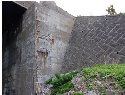
写真4-23 鉄筋の腐食によるひびわれ、うき
