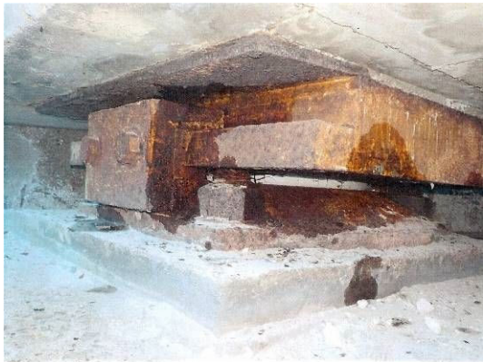
写真4-2 【損傷】支承の腐食
