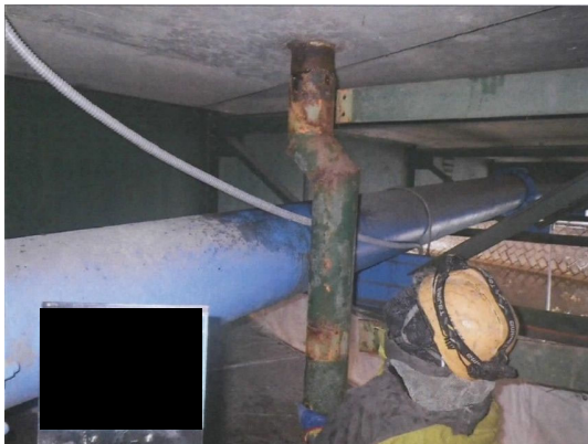
写真 4-11 【損傷】排水管腐食
