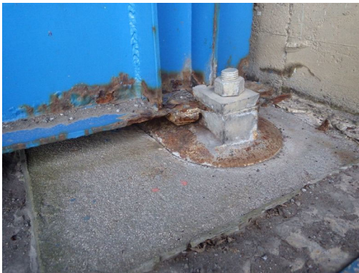
写真4-22 主桁端部の腐食事例
