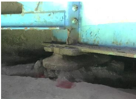
写真4-5 【損傷】 支承の腐食、沓座モルタル欠損
