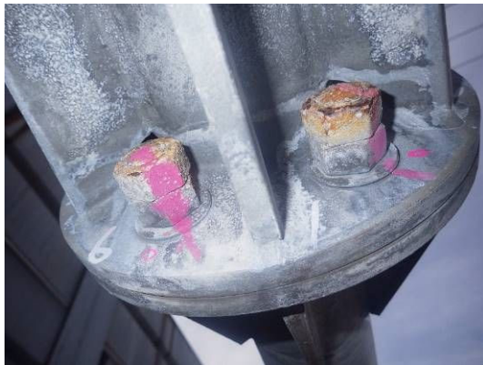
写真4-20 【損傷】ナット腐食
