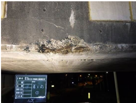
写真4-14 【損傷】 断面欠損、PC鋼線の露出・破断
