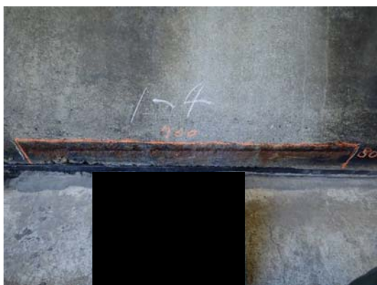
写真4-20 【損傷】鉄筋の露出
