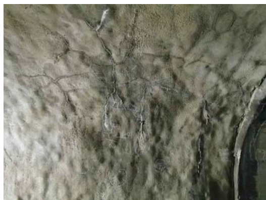
写真4-17 【損傷】うきの状況
