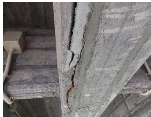
写真4-23 鉄筋の腐食によるひびわれ、うき
