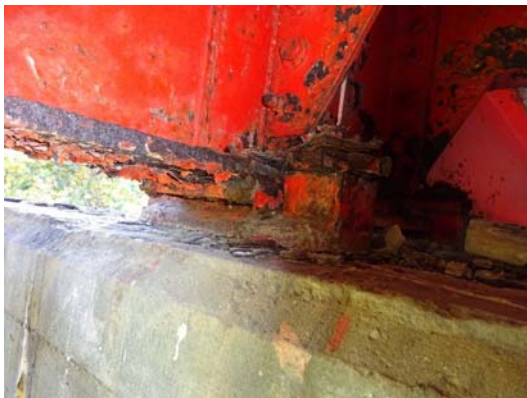
写真4-14 【損傷】支承の腐食状況
