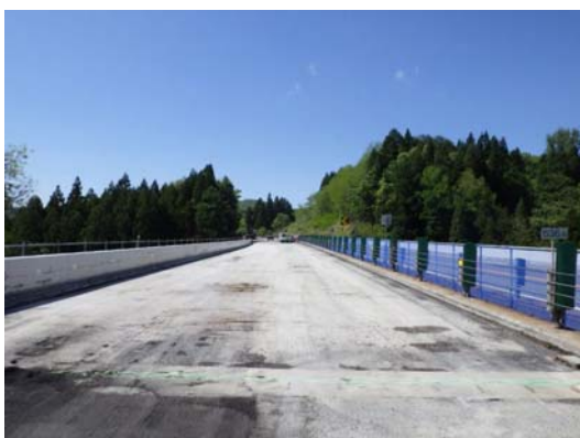
写真4-8 【損傷】床版上面の損傷状況
