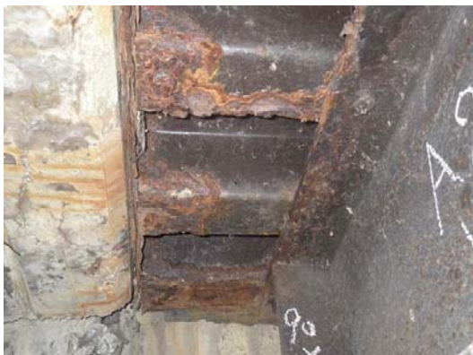
写真4-11 【損傷】床版の腐食状況
