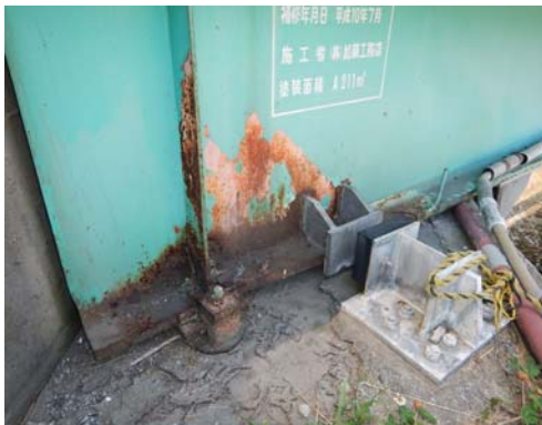
写真4-22 主桁端部の腐食事例
