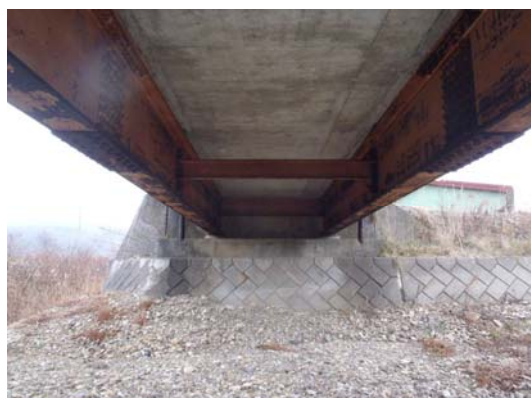
写真4-2 【損傷】桁材の腐食状況
