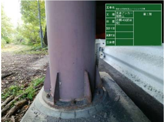
写真4-17 【損傷】 スノーシェッドの腐食、変形・欠損状況
