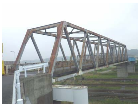
写真4-5 【損傷】トラス桁の腐食
