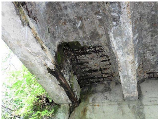
写真4-20 【損傷】 床版の剥離・鉄筋露出（一部破断）状況
