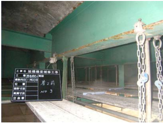
写真4-14 【損傷】 鋼橋の桁材等の腐食状況
