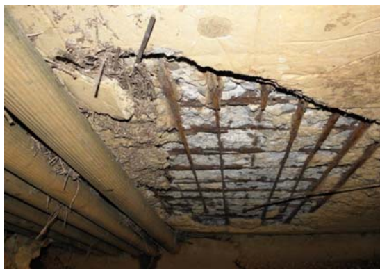
写真4-11 【損傷】 床版の剥離・鉄筋露出状況
