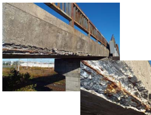
写真4-4 【損傷】主桁の欠損
