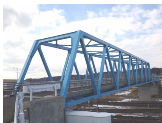
写真4-6 【対策】断面修復・塗替え
