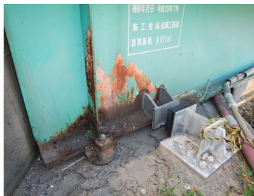
写真3-3 主桁端部の腐食事例
