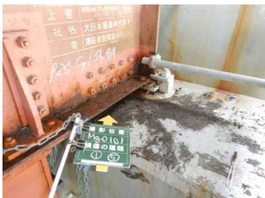
写真4-8 【損傷】主桁端部の腐食状況
