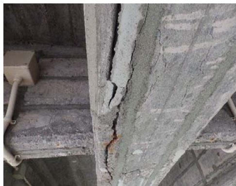
写真3-4 鉄筋の腐食によるひびわれ、うき
