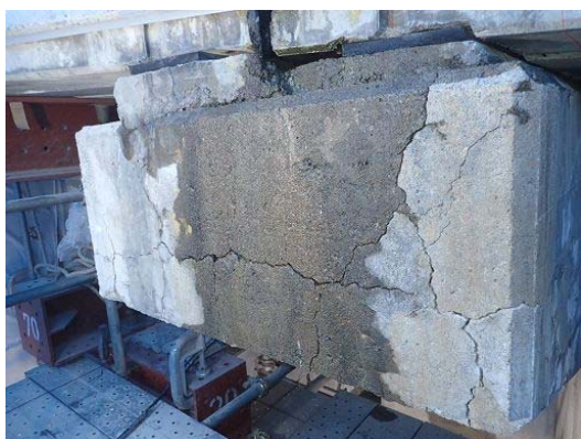
写真4-2 【損傷】 T型橋脚張出し部の著しいひびわれの状況
