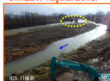
※H5河道では、平常時の流速が低下する箇所で、土砂が堆積し砂州が形成されやすい、近年は砂州上の樹林化が進行していた。台風18号後に、砂州上の樹木がフラッシュされ、さらに掘削工事が行われて砂州地形が現れ、河道内の環境が変化しており、砂州の上流で、早瀬の形成が見られる。
