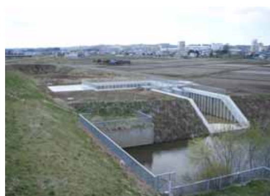
浅水川排水ピット
