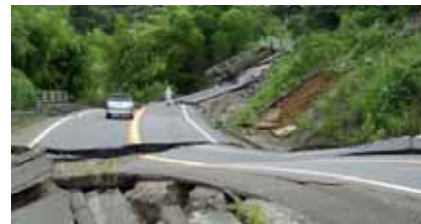
被災状況調査
