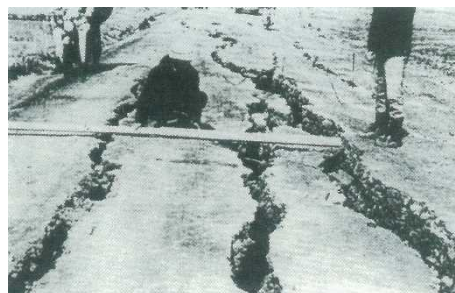
十勝沖地震による馬淵川堤防天端の亀裂
