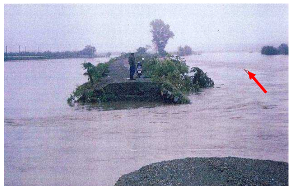
平成 2 年（1990 年）9 月洪水 三戸郡南部町虎渡地区 左岸堤防の決壊状況
