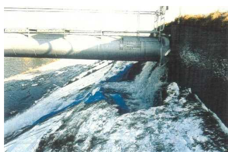
三陸はるか沖地震による水管橋の破管
