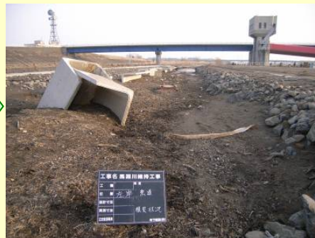
被災状況 H23. 3. 14撮影
