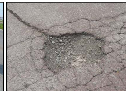
堤防舗装の損傷
