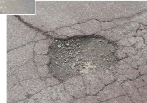
堤防舗装の損傷
