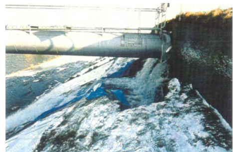
三陸はるか沖地震による水管橋の破管
