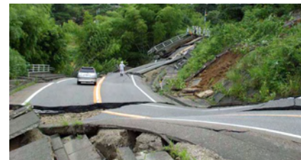
被災状況調査
