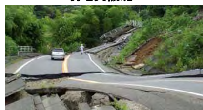
被災状況調査
