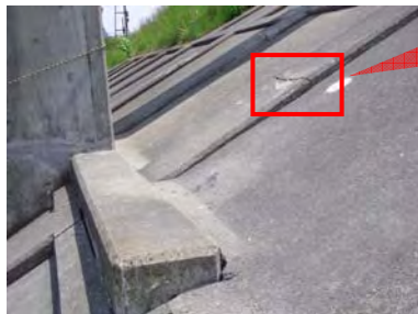
護岸の損傷状況
