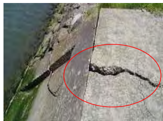
劣化によるひび割れ状況
