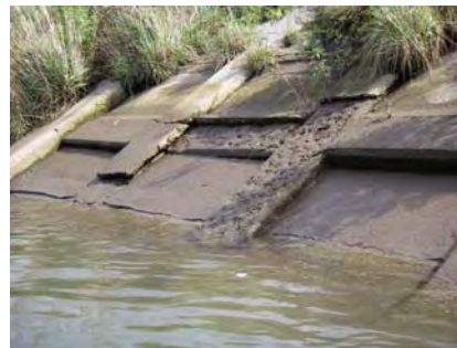
護岸損傷の状況
