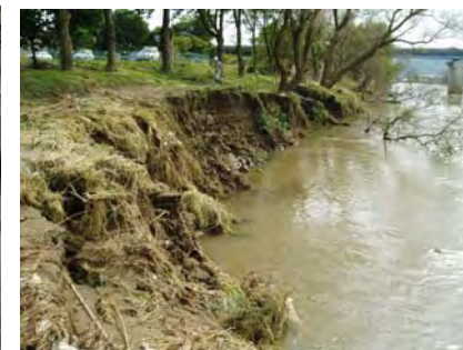
河岸洗掘の状況
