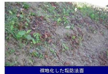
裸地化した堤防法面
