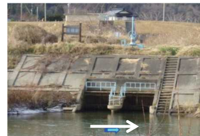
施設名称:根岸揚水機場 管理者 :馬淵川土地改良区
