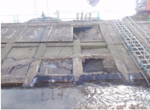
護岸の損傷状況
