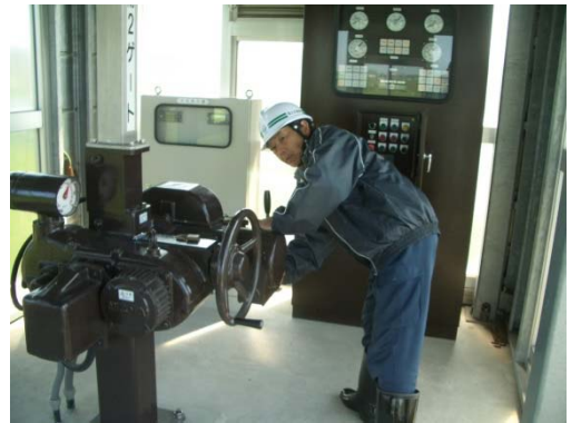
設備の点検状況（水閘門操作員による点検）
