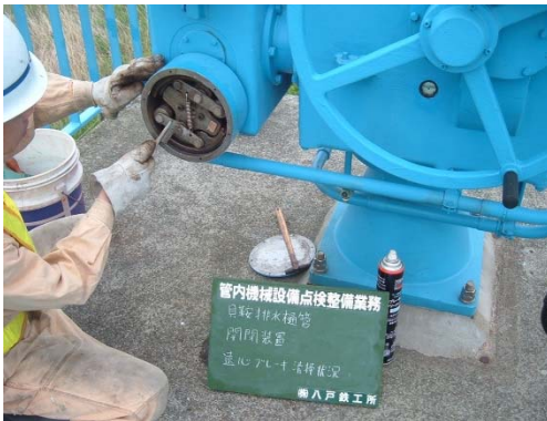
設備の点検状況（専門業者による点検）
