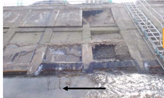
護岸の損傷状況(H26年4月)
