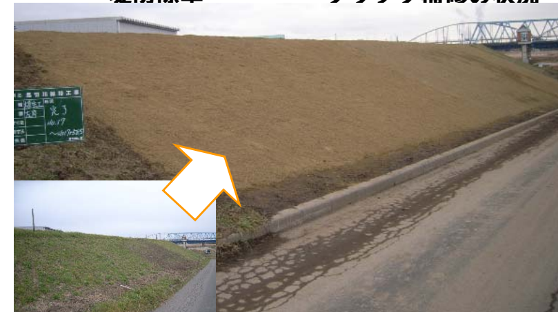
堤防点検で確認した裸地化部分
