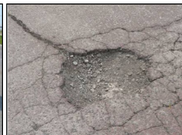
堤防舗装の損傷
