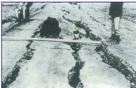
十勝沖地震被害状況 馬淵川堤防天端の亀裂
