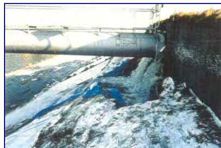
三陸はるか沖地震被害状況 水管橋の被害
