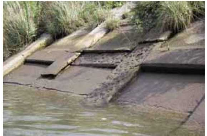
護岸損傷の状況
