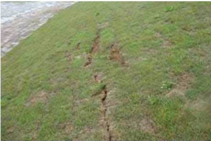
降雨による堤防法面の崩壊
