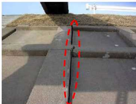
(護岸部の開口・亀裂)
