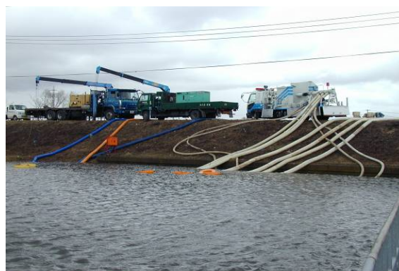
五所川原市相原地内での内水排除状況 (出典：青森河川国道事務所)
