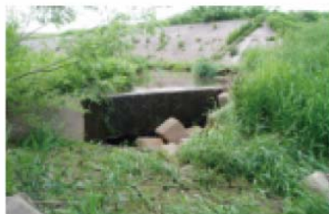
合流部で段差が生じている水路
