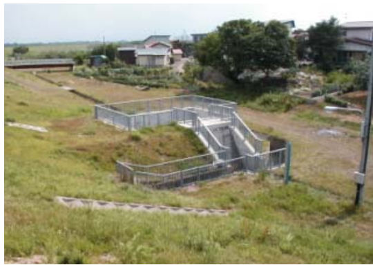
弘前市鳴瀬地区排水ピット
