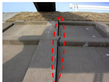
(護岸部の開口・亀裂)
