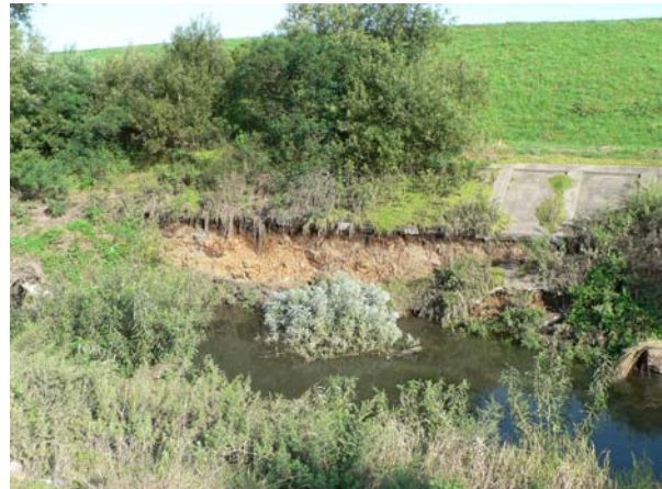
洪水による護岸の損傷の状況
