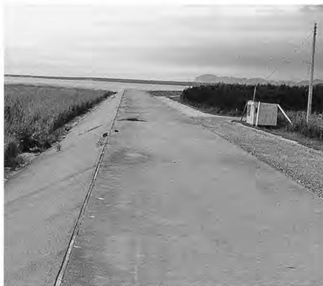
災害復旧で三面張アスコンで復旧された現在の右岸囲繞堤
