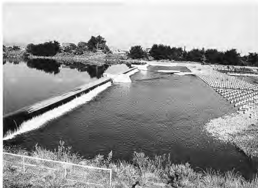
弘前市上水道ラバーダム
