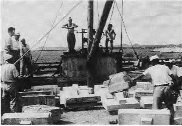
右岸囲繞堤工事 (運搬船からコンクリートブロックを陸揚げ 昭和25年8月)
