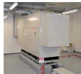
非常用発電設備のイメージ
