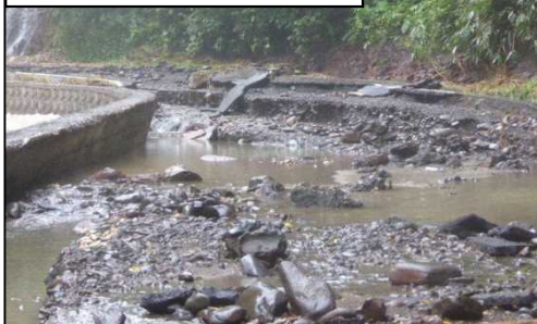
被災状況：8月12日撮影
