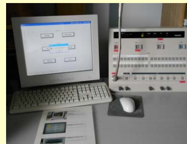
既存設備操作卓
