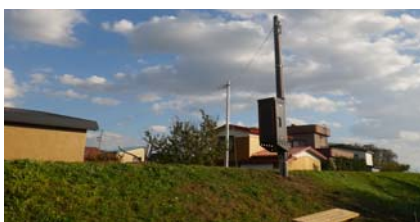
簡易水位計設置状況（イメージ写真）
