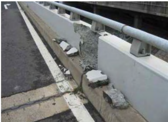
地震の影響で塩町第三高架橋の 壁高欄の一部がはく落
