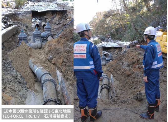
送水管の漏水箇所を確認する東北地整TEC-FORCE (R6.1.17 石川県輪島市)
