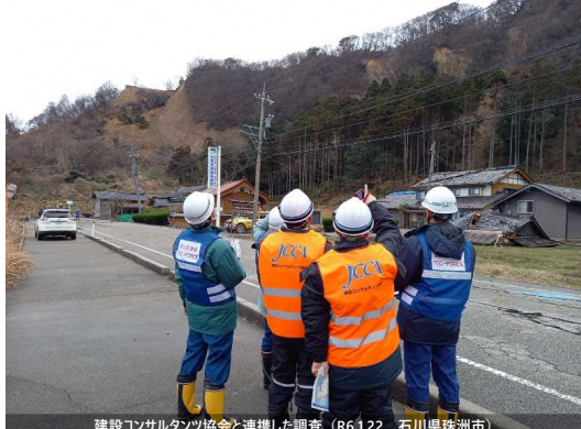
建設コンサルタンツ協会と連携した調査 (R6.1.22 石川県珠洲市)
