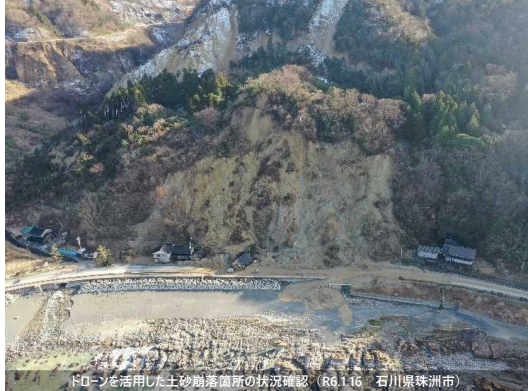
ドローンを活用した土砂崩落箇所の状況確認 (R6.1.16 石川県珠洲市)
