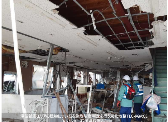
津波被害エリアの建物について応急危険度判定を行う東北地整TEC-FORCE (R6.1.20 石川県珠洲市)
