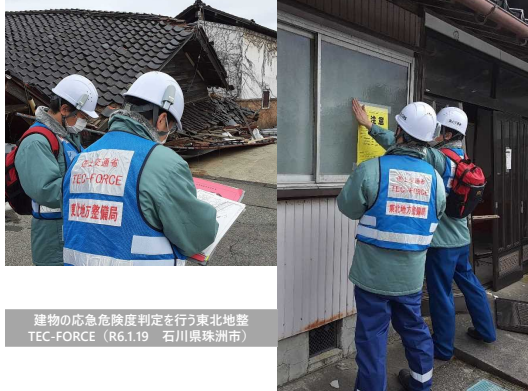
建物の応急危険度判定を行う東北地整TEC-FORCE (R6.1.19 石川県珠洲市)
