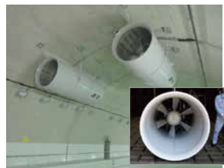
トンネルジェットファン
